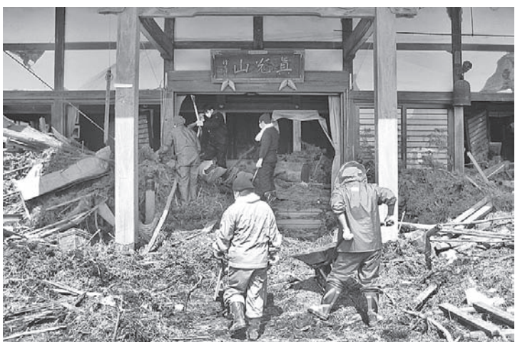
専能寺では寺院機能の早急な回復を目指し、ボランティアにより本堂に流入した瓦礫などが撤去されている
