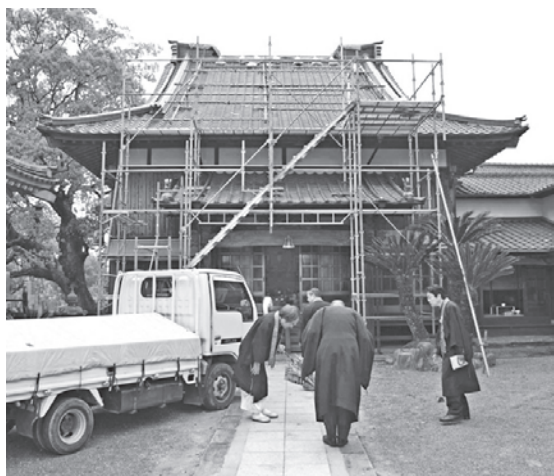
本堂屋根の瓦崩落などの被害があった佐賀県神埼市の光顕寺(廣江頭住職)
