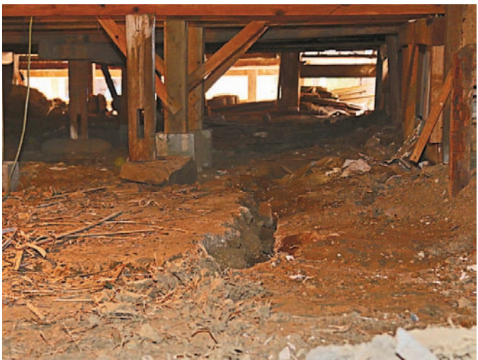
本堂軒下に幅20センチの亀裂
