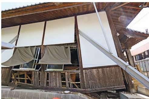
大きく傾いた大光寺の本堂。境内の右隣にある同寺保育園の園児たちの安全を確保するため金属製の防壁が建てられている
