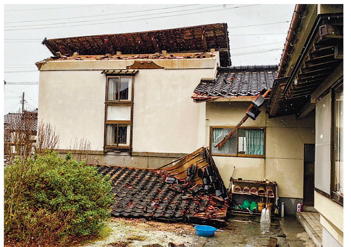
庫裏の屋根が落下した石川県七尾市・大乘寺(北藤誠住職)。このほか本堂柱すれ、白壁剥落、経堂壁剥落などの被害
