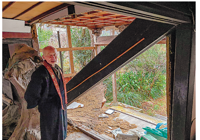
玄関の梁が落下した石川県七尾市・勝円寺(聖學學短住職)。このほか鐘楼倒壊、本堂の厨子倒壊、欄間落下などの被害
