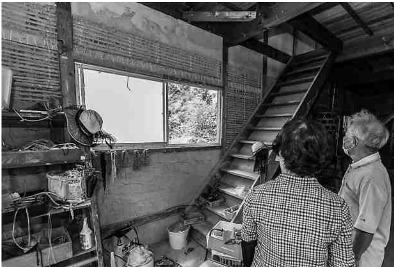
自宅から一段低い納屋は2.5m以上浸水した。土壁が落ちたままになっている
